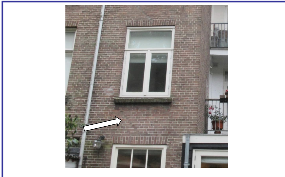
achtergevel; lichte zettingscheur
