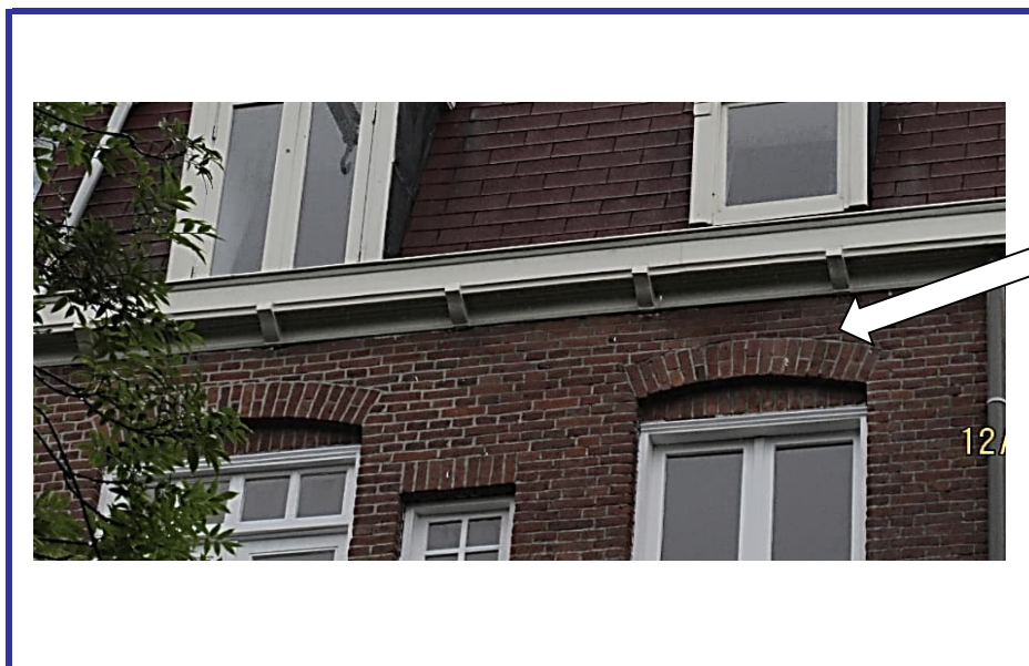
voorgevel; boogconstructie iets gezet
