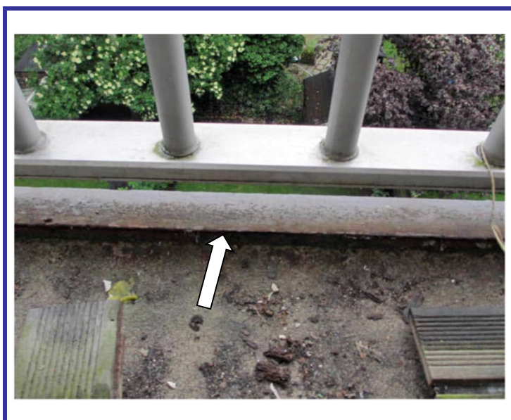
balkon; randbalk roestig
