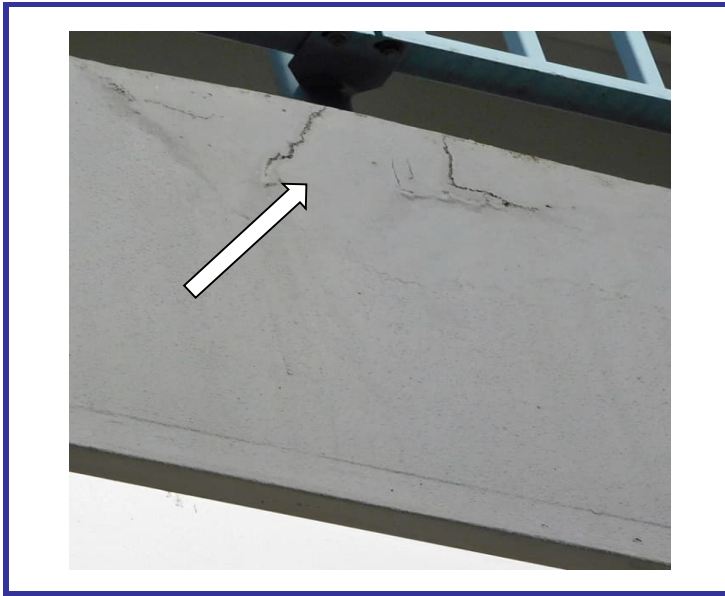
zijgevel betonconstructie; hier en daar betonrot aanwezig
