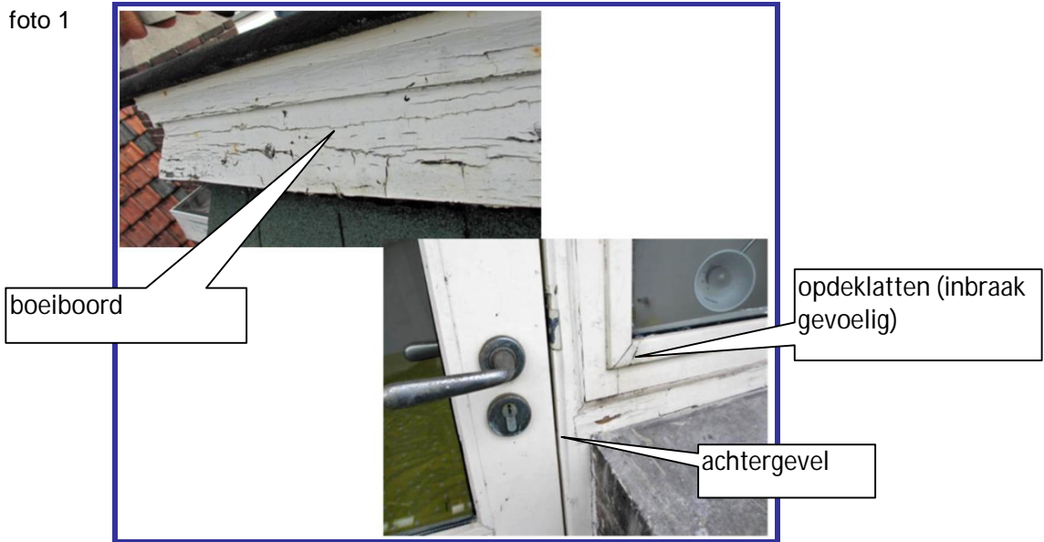
schilderwerk; hier en daar slechte plekken
